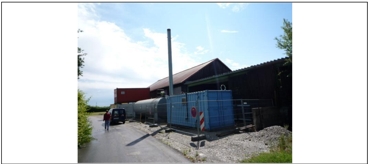
Abbildung 3: Provisorische Heizzentrale im Gewerbegebiet
